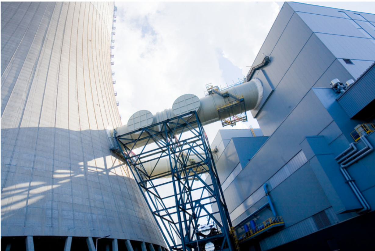
Zdjęcie przedstawiające kanał spalinowy przystosowany do przyłączenia instalacji CCP (pobór i zrzut spalin). W niższej części metalowej konstrukcji widać część instalacji wody chłodzącej dla CCP.
