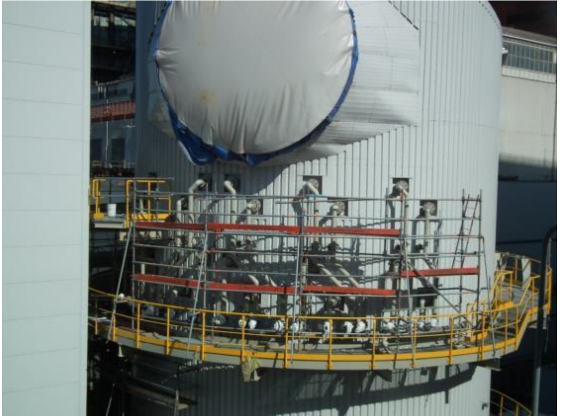
Wyposażenie absorbera i budynku pompowni umożliwiające rozruch ciągu technologicznego odsiarczania
