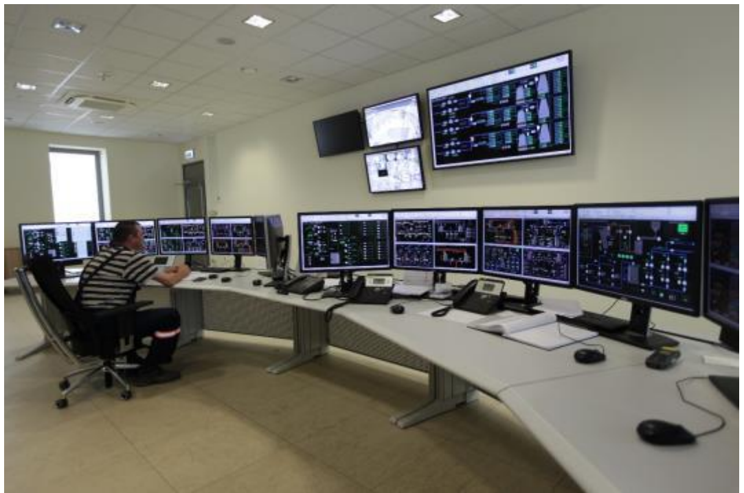
Nastawnia instalacji mokrego odsiarczania
