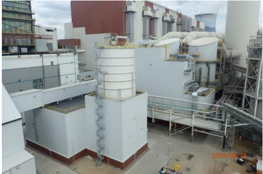
Widok na instalację mokrego odsiarczania spalin
