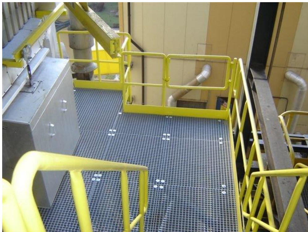
Absorber – poziom półki sitowej
